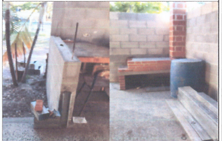
Foto 4: mejoramiento en cocina de leña, fundición de desayunador y colocar azulejo, barandal para evitar acceso de las alumnas al area de cocina
