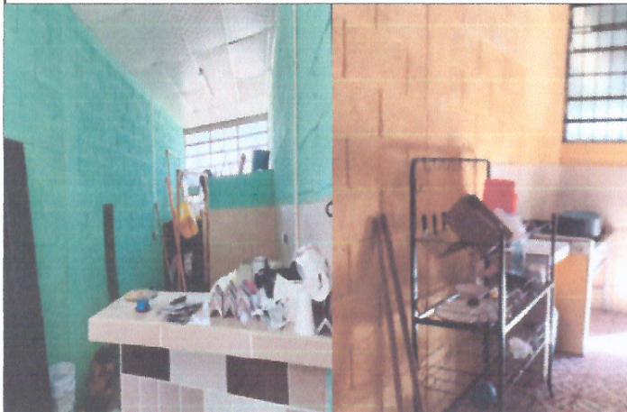
Foto 3: mejoramiento en cocinas ( fundicion de gabinetes para resguardo de alimentos y utensilios de cocina)
